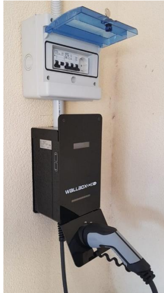
Estación de carga lenta domiciliaria
