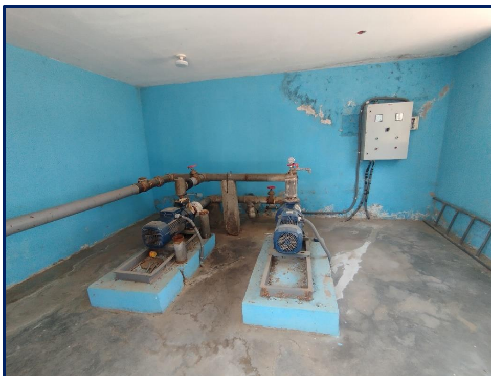
Fotografía 9. Vista del interior de la caseta de bombeo
