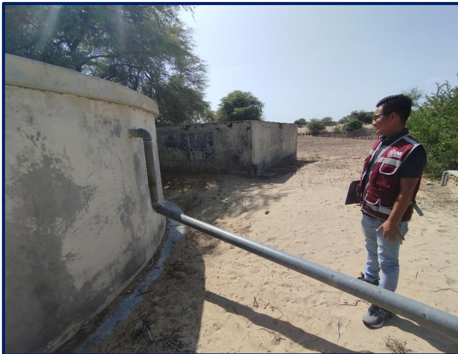
Fotografía 7. Tubería expuesta sin un apoyo en el codo 90°
