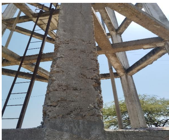
Cangrejeras en columnas del Reservorio Elevado
