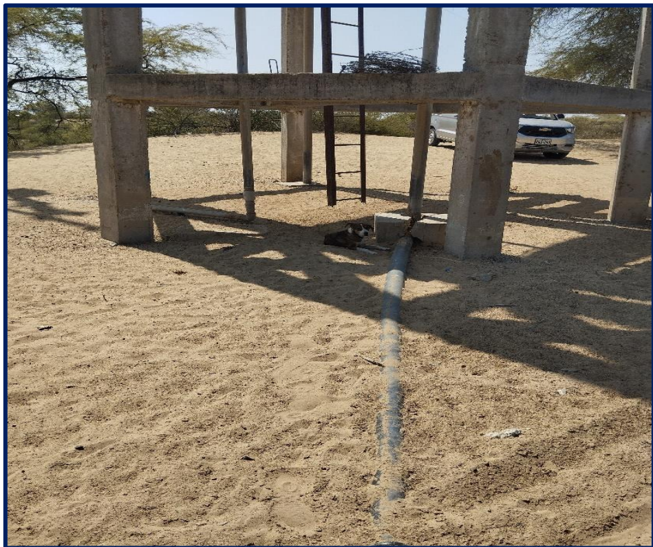
Fotografía 11. Línea de impulsión expuesta sobre la superficie
