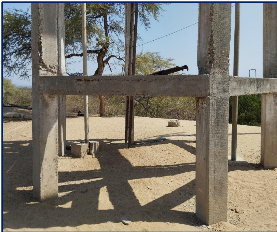
Fotografía 13 Deficiencias en la estructura del Reservorio Elevado
