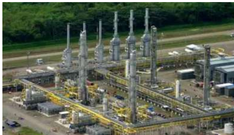
Planta de fraccionamiento de Malvinas
